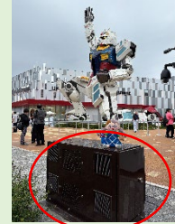
地上変電施設（電気通信グループ）
