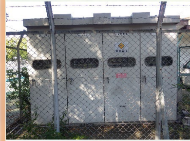
高圧受変電設備(公園)
