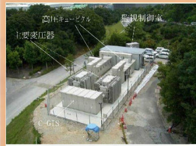
特別高圧受変電設備(博覧会)
