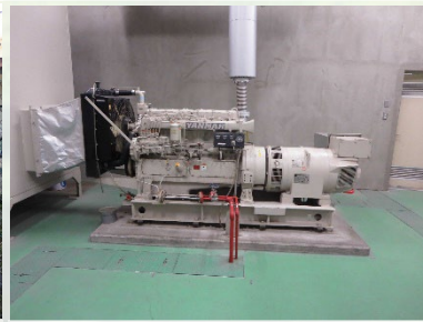
非常用発電設備(トンネル)
