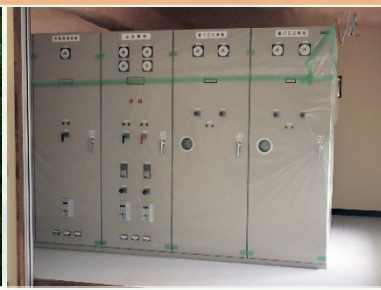
高圧受変電設備(ダム)
