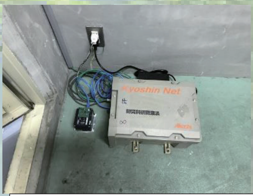
電気室内の地震計の様子
