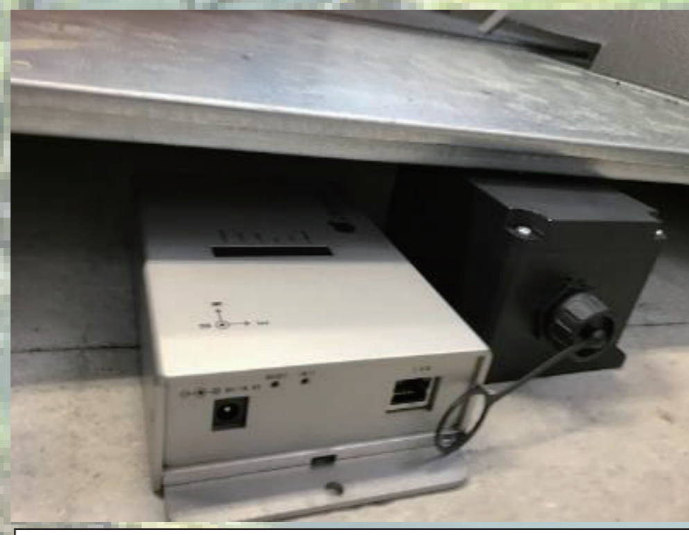
0Aフロアと地震計の様子
