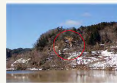
▲ 貯水池周辺道路路面崩落
