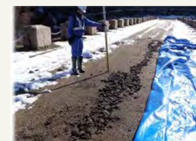
▲ 堤体天端舗装クラック
