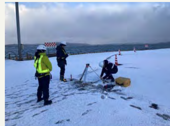
▲ 棧橋の変状の測量
